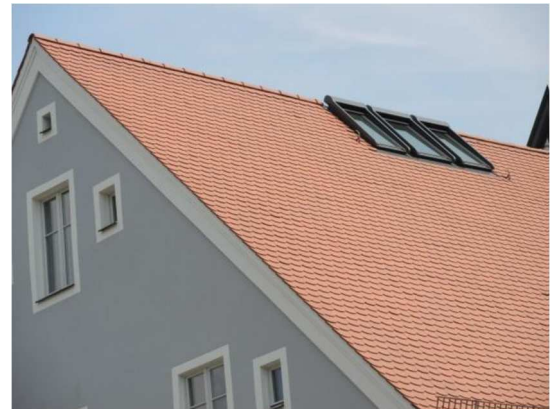
Untergeordnete Anlage aus Dachflächenfenstern
