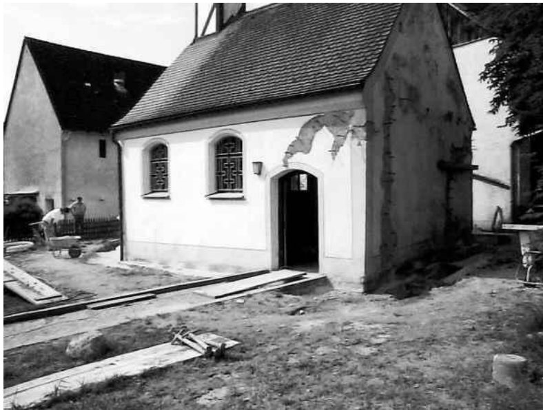
Bild: Die Kirche im Ortsteil Haunsfeld wird derzeit saniert. Nun wurden die anstehenden Malerarbeiten vergeben.
