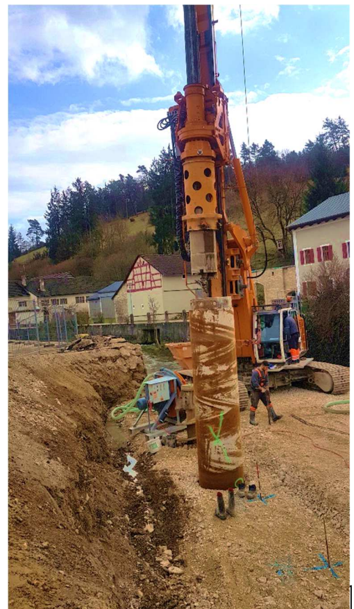
heim sind gestartet. Derzeit werden die neuen Bohrpfähle für die Brücke gesetzt.
