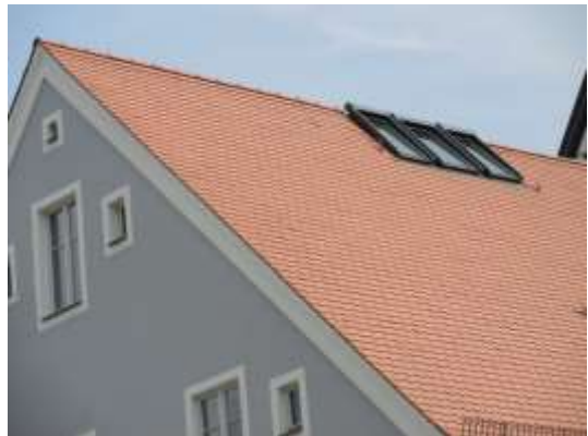
Untergeordnete Anlage aus Dachflächenfenstern
